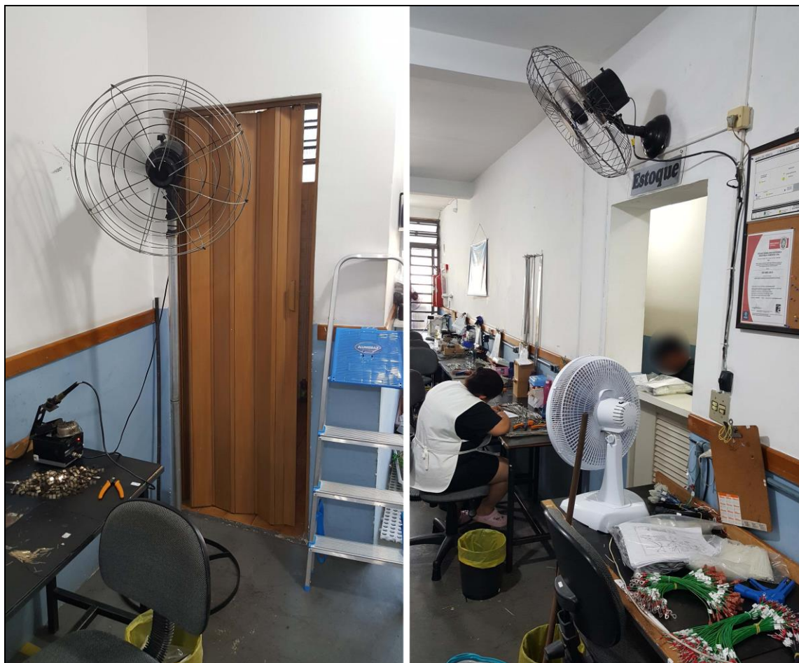
Figura 33 – Sistema de ventilação existente
